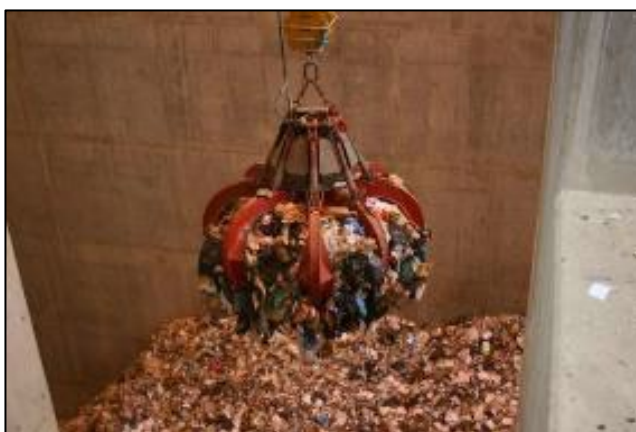
Figure 7 : Grappin sur pont-roulant en fosse
